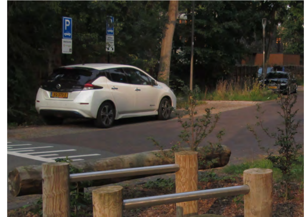
Elektrische laadpalen in de openbare ruimte naast het fietsparkeren
